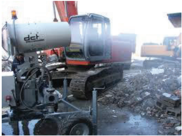
Figura 3 – Cannone abbattimento polveri
